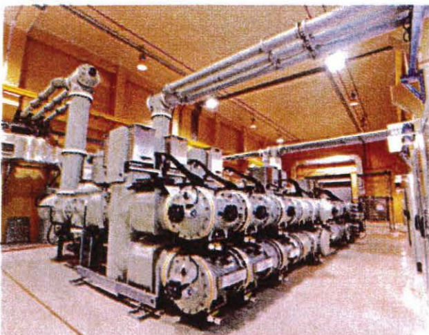
Die geplante 110 kV Schaltanlage ist wartungsarm, witterungsbeständig, hat eine lange Lebensdauer und gewährleistet ein hohes Maß an Personen- und Betriebssicherheit.
