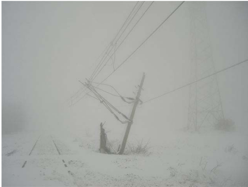
Abbildung 10 Beschädigte Oberleitung - Quelle ÖBB
