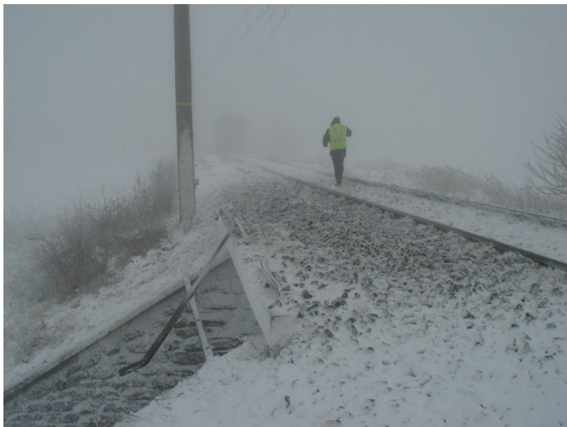
Abbildung 9 Beschädigtes Brückengeländer - Quelle ÖBB
