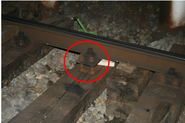
Abbildung 2 Gelockerte Schwellenschrauben am in Fahrrichtung linken Schienenstrang
