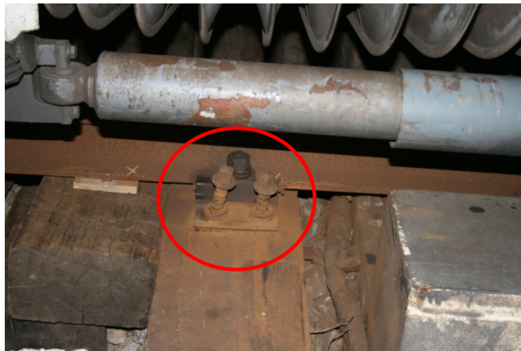
Abbildung 3 Gelockerte Schwellenschrauben am in Fahrrichtung rechten Schienenstrang
