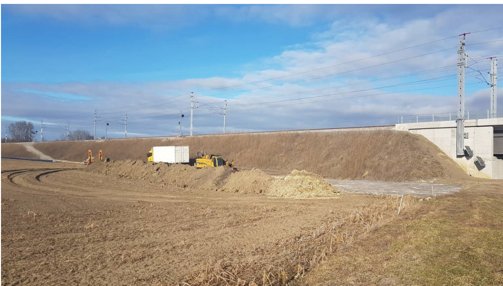
Abbildung: Dammlage (rd. 6m) im Bereich zwischen Heidbach- und Schwechatbrücke von Westen (Foto: Kühnert, 14.02.2019)
