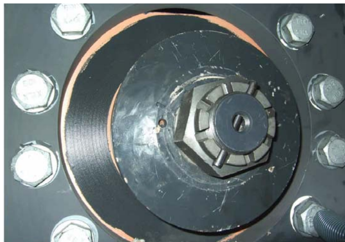
Abbildung 7 Für Überführung montierte Kronenmutter mit neuem Spannstift (Quelle Gutachten)
